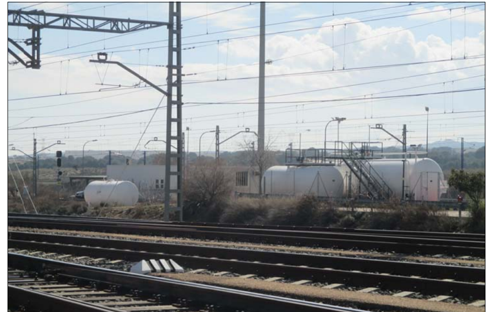
Instalación de combustibles
