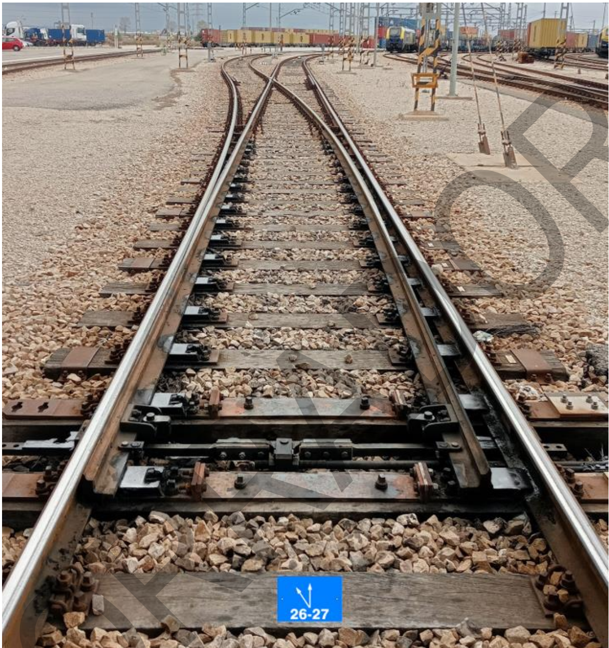
Figura 12. Situación de la Placa de identificación de vías a las que sirve un desvío de un haz de más de 2 vías.
