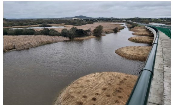
Figura 22. Estado final de la reposición de la EX209
