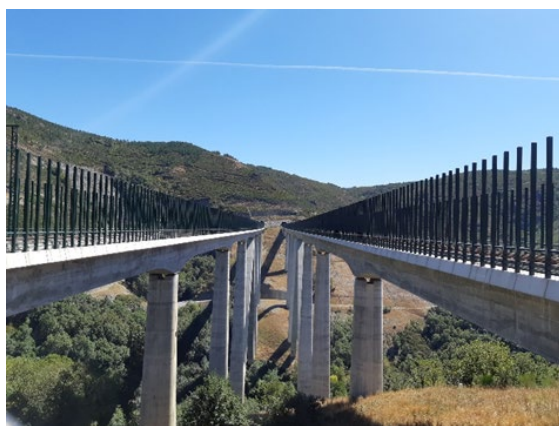
Figura 20. Pantallas anti-colisión en el viaducto de Teixeiras (LAV Madrid – Galicia)
